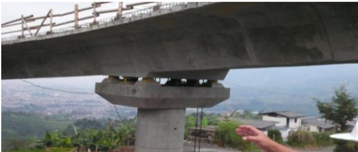
Figura 4. Aislador Viaducto El Helicoidal
