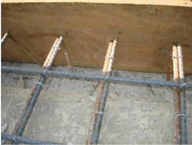
Figura 6 _ Detalle de la armadura de acero en el extremo de una losa maciza
