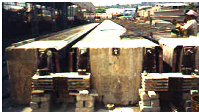
Molde y mesa de colado de concreto presforzado para traveses doble T
