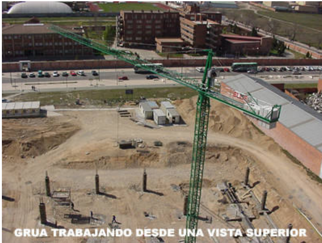
Fig. 10-12. La torre grúa y el cubo pueden manejar el concreto fácilmente en construcciones de edificios altos.
